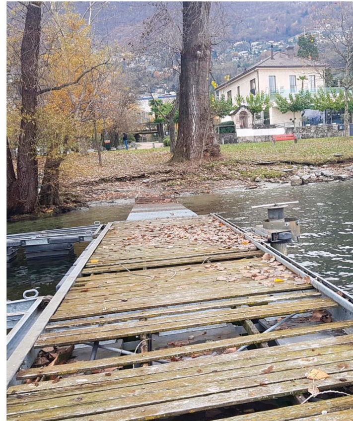
Il pontile mezzo affondato e, sullo sfondo, l'esclusivo Giardino Lago
